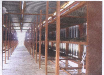
Instalații pentru uscarea plantelor/ Herb drying installation
